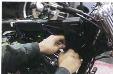
上のナンバー灯と同じように、あとは配線に繋げば作業は完了。ソフトテイル系モデルの場合、タンク内側のこの箇所にウインカーのカプラーが配置されている。
